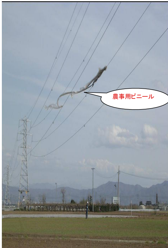
送電線鉄塔(ビニール)
